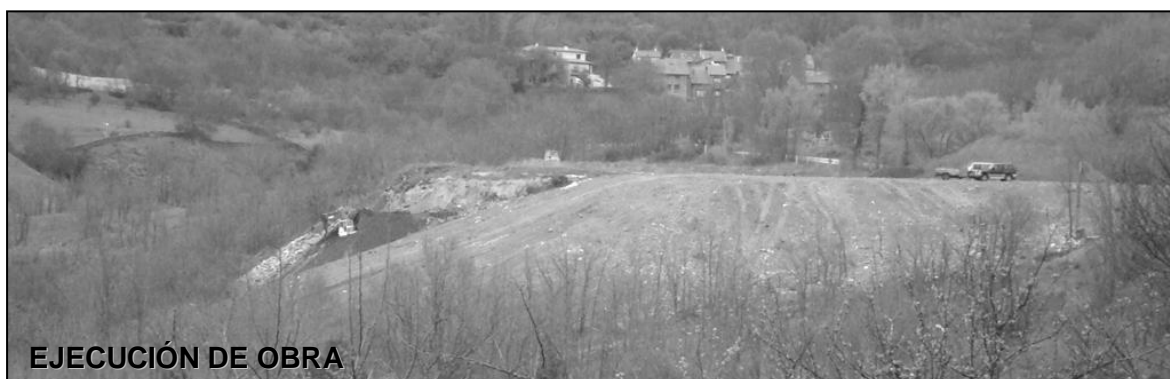
Fotografía 12. Se aprecia la pendiente suavizada en parte del talud, mientras siguen trabajando en la zona más lejana. Ya no se ven residuos en superficie
